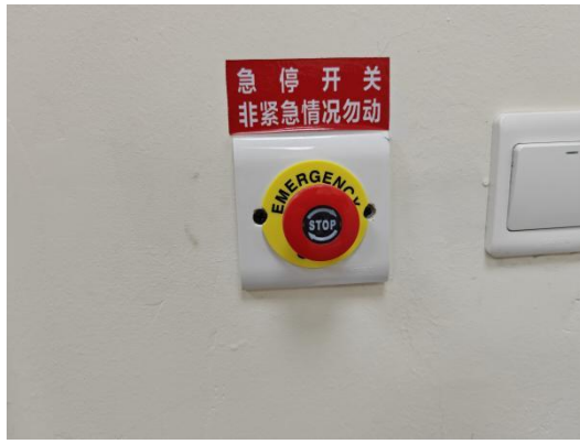
墙面紧急停机按钮（控制室）
